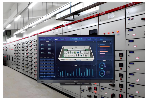
变配电监控系统
